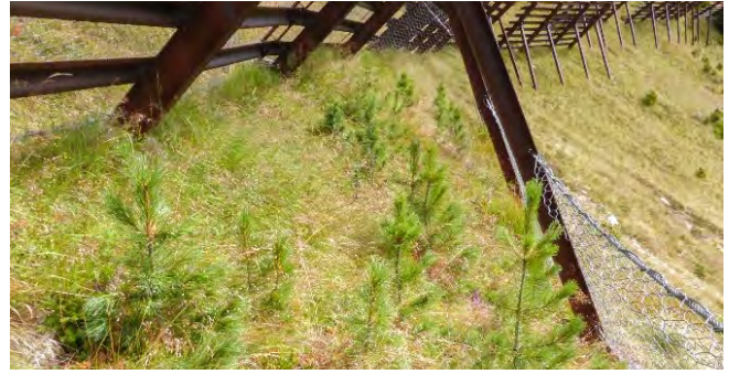
Verbisskontrollzaun im Anbruchgebiet der Goldeforlawine, Gaschurn, zeigt die Entwicklung der aufgeforsteten Zirben ohne Schalenwildeinfluss
